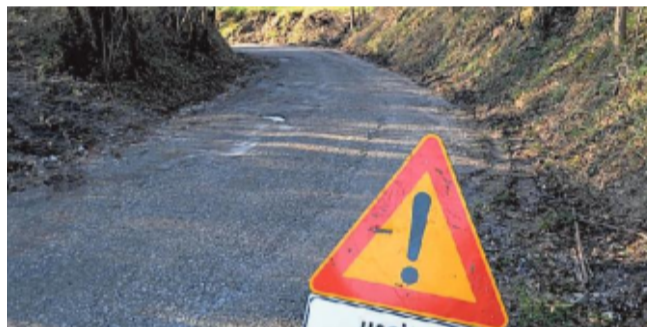
La strada dissestata in località Busa dal Diau
