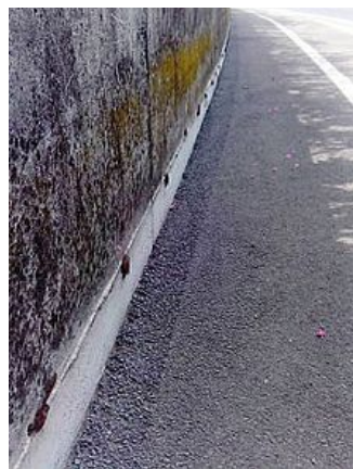
I ferri che spuntano dal muro
